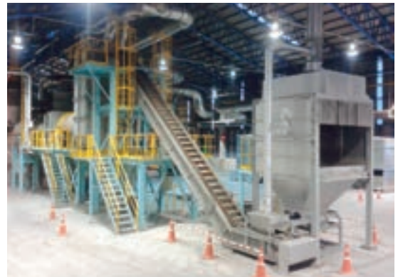
写真3 原料予熱キルン設備
